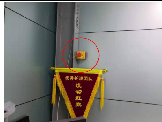
Pic4 控制室内紧急停机按钮
