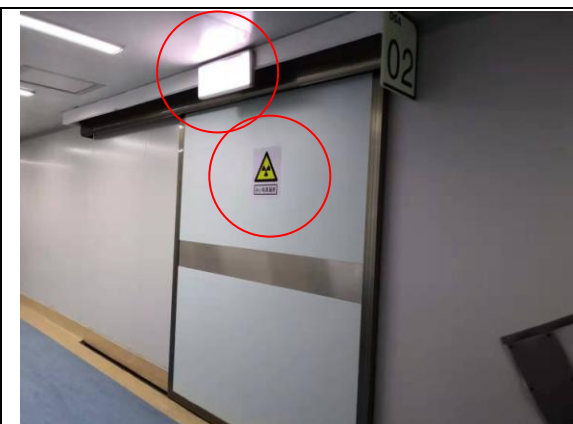
Pic1 防护门电离辐射警示标志和警示灯
